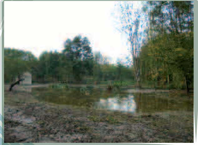
Travaux de restauration de la zone humide du Moulin de la Porte - Estouy
