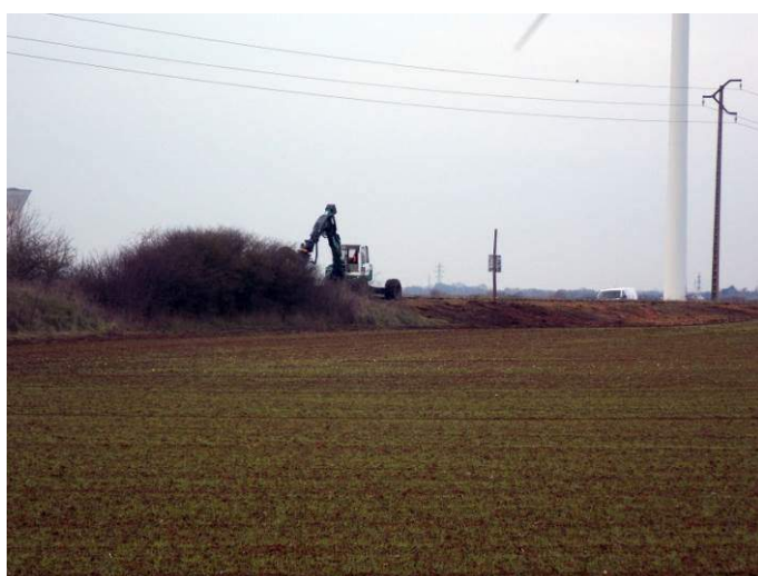
Travaux lourds de défrichage d'une voie ferrée désaffectée en hiver à proximité d'Audeville.
