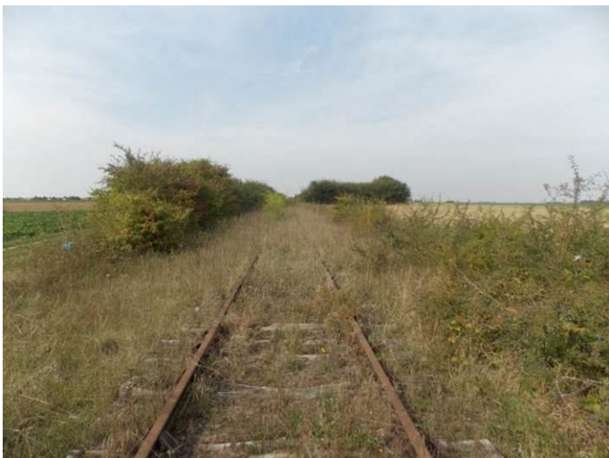
Voie ferrée non exploitée enherbée encadrée ponctuellement de haies à hauteur de Sermaises
